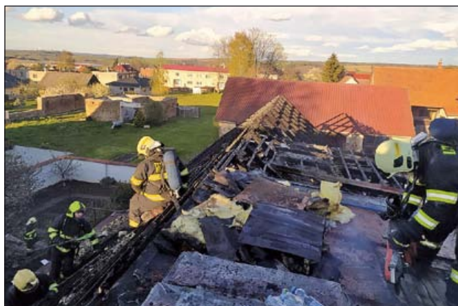
Požár rodinného domu v Čechtích; foto archiv JSDH
