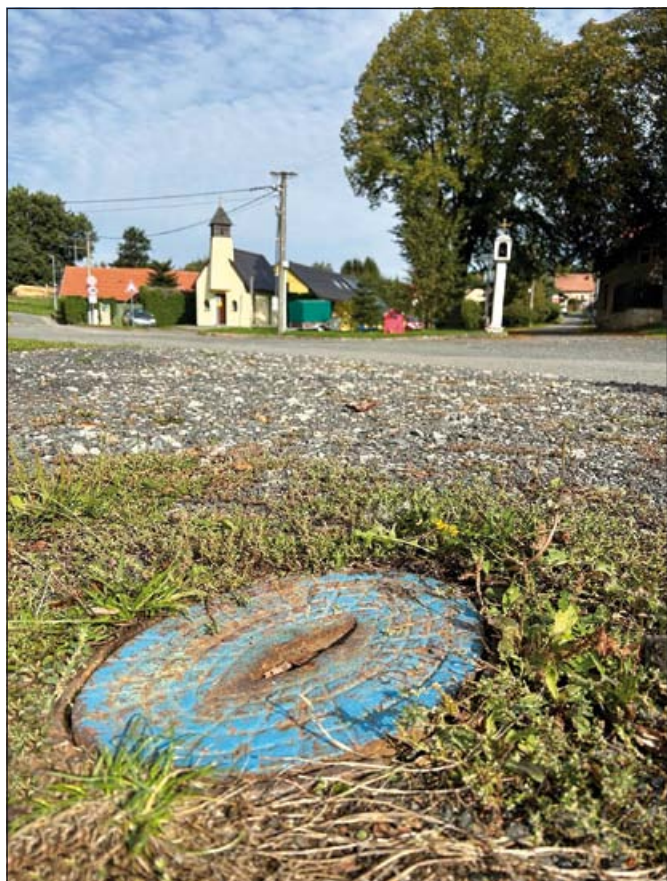
Rozvody pitné vody si žádají rekonstrukci; foto archiv města
