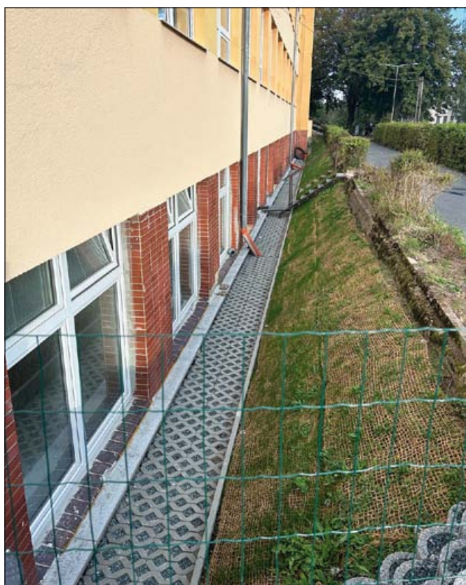
Odvětrání kolem budovy ZŠ; foto archiv města
